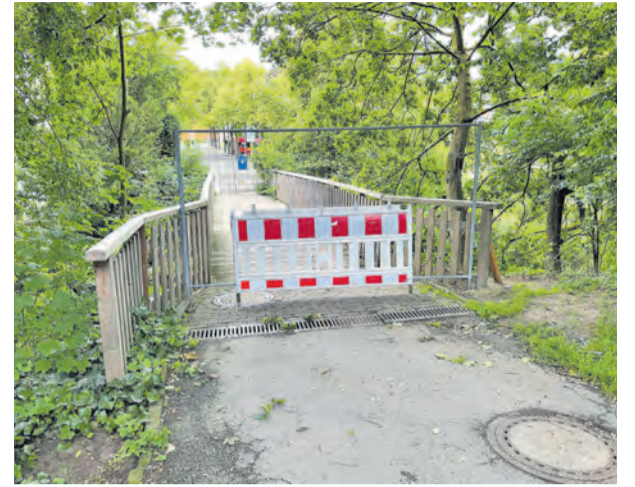
Die Fußgängerbrücke in der Bleichstraße bleibt bis auf weiteres gesperrt.
